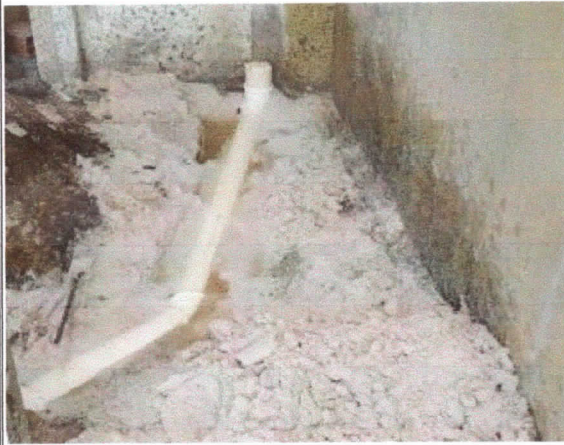
Esgoto, tubulação de coleta banheiro presidência, superior.
