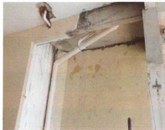
Esgoto, sistema de coleta banheiro presidência, superior.
