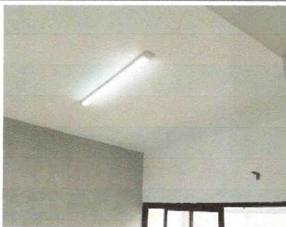
Elétrica, luminárias tipo led, sobrepor, instaladas, gabinetes.
