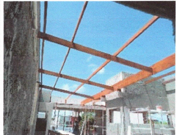
Cobertura, montagem de estrutura de madeira de sustentação do telhado pavimento superior.
