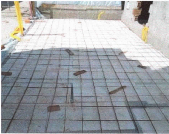
Pavimentação, enchimento de rebaixo existente, 15cm. pavimento superior, sala administrativo, armação de malha de aço CA60 5.0mm2.
