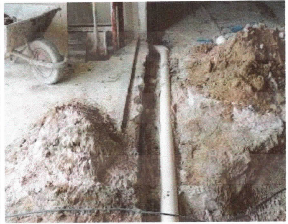
Esgoto, tubulação de coleta banheiro presidência, superior
