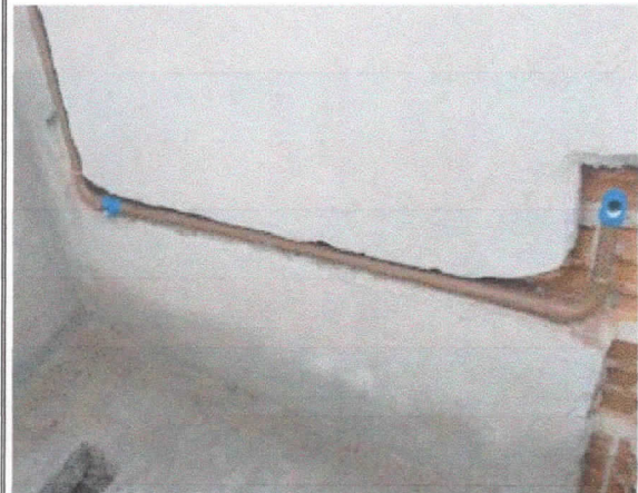
Hidráulica, instalação de abastecimento vaso sanitário e lavatório, banheiro sala presidente, superior
