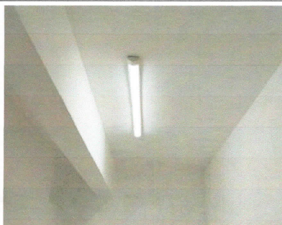
Elétrica, luminárias tipo led, sobrepor, instaladas, gabinetes.
