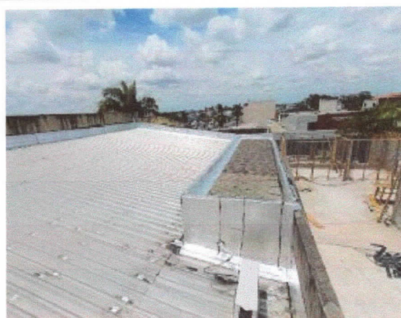
Coberturas, revestimento de calha de chapa de zinco com manta de alumínio a quente, cobertura do plenário.
