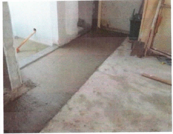
Pavimentação, regularização de contra piso decorrente de demolição de piso de alta resistência, área de acesso ao elevador PNE e escada, térreo.
