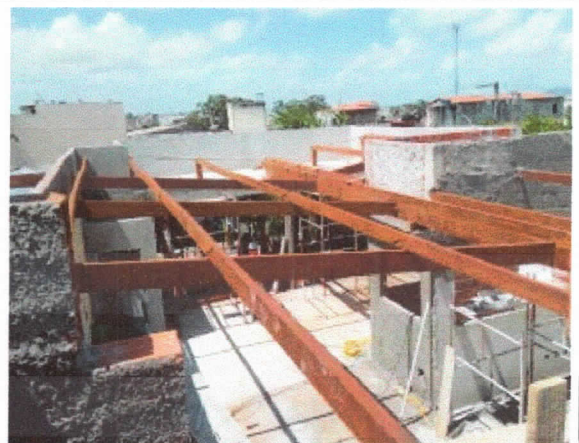
Cobertura, montagem de estrutura de madeira de sustentação do telhado pavimento superior.
