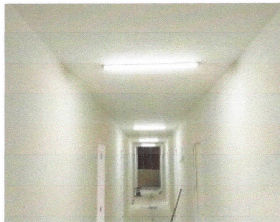
Elétrica, luminárias tipo led, sobrepor, instaladas, circulação dos gabinetes.
