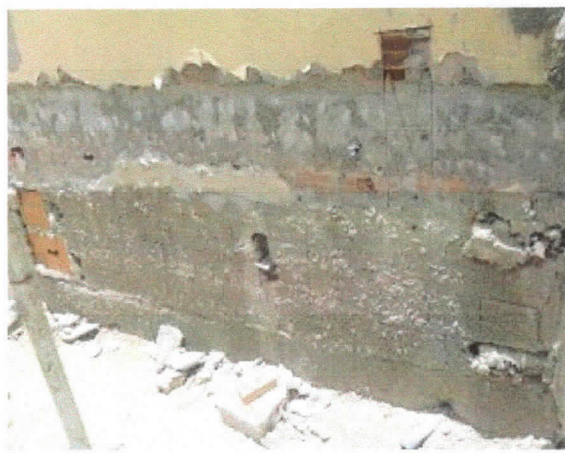
Revestimento, demolição de reboco existente sobre parede externa do plenário, sala do Presidente.
