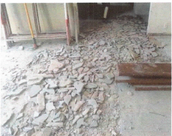
Pavimentação, demolição de piso de alta resistência hall de acesso à recepção, térreo.
