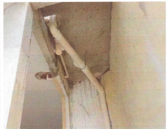
Esgoto, sistema de coleta banheiro presidência, superior.
