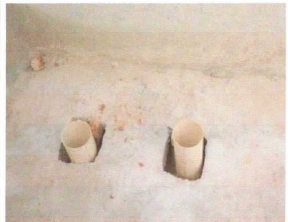
Esgoto, pontos de vaso e caixa sifonada, banheiro presidência, superior.
